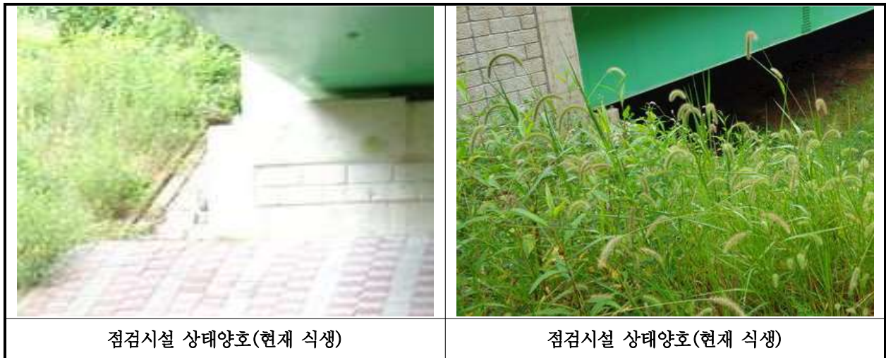
【사진 25.3.24】 교량 점검시설 손상현황
